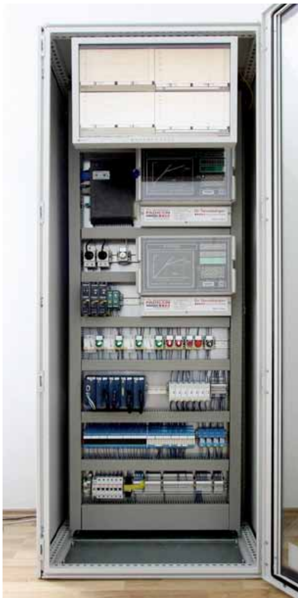
Bild 1: Schaltschrank der Dr. Tanneberger GmbH mit Energiemanagementsystem und integrierter Parallel-Differenzstrom-Regelung Padicon zur Optimierung der Lastgänge einzelner Verbraucher (Quelle: Dr. Tanneberger)
